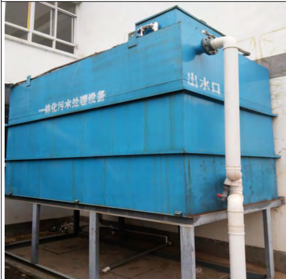
项目一体化污水处理设备
